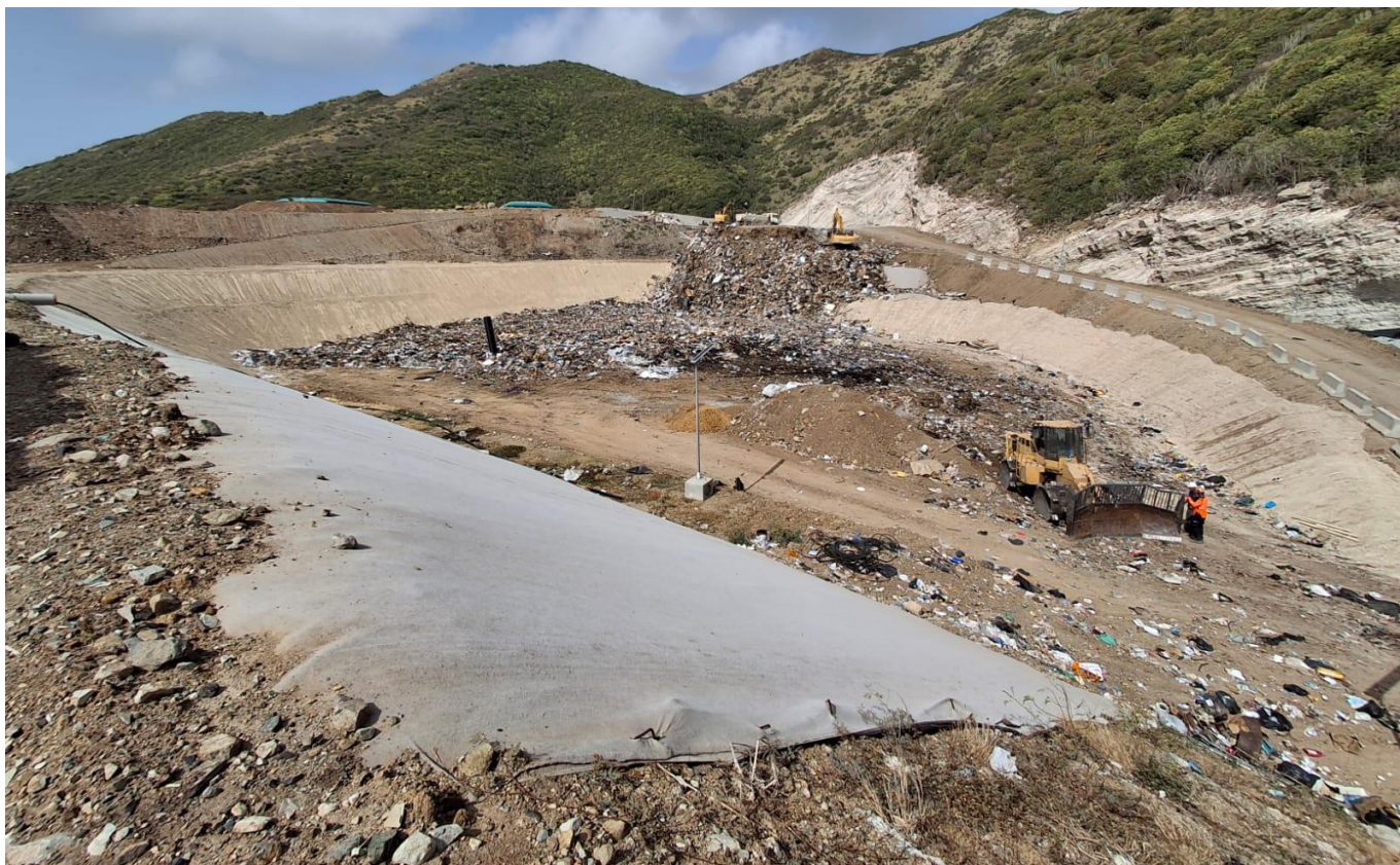
Figure 14 : Recouvrement en argile de la BSA dégradée par l'incendie
