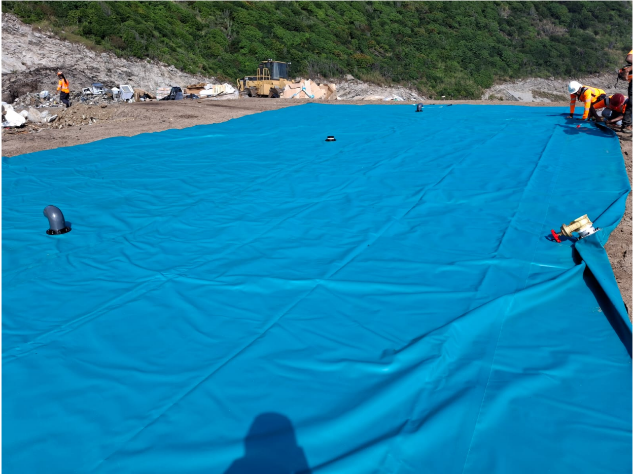
Figure 21 : Bâche incendie de 150m3
